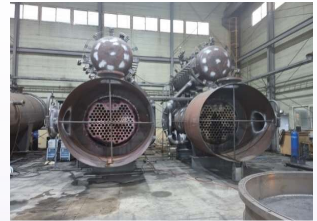
포스코 HP Boiler
