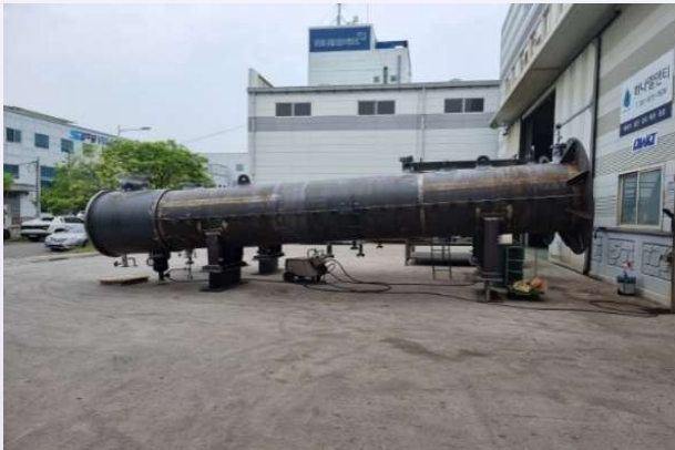
포스코 LP Boiler
