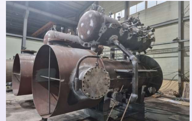
포스코 HP Boiler
